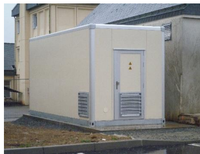
Shelter Laval THD de Louverné
